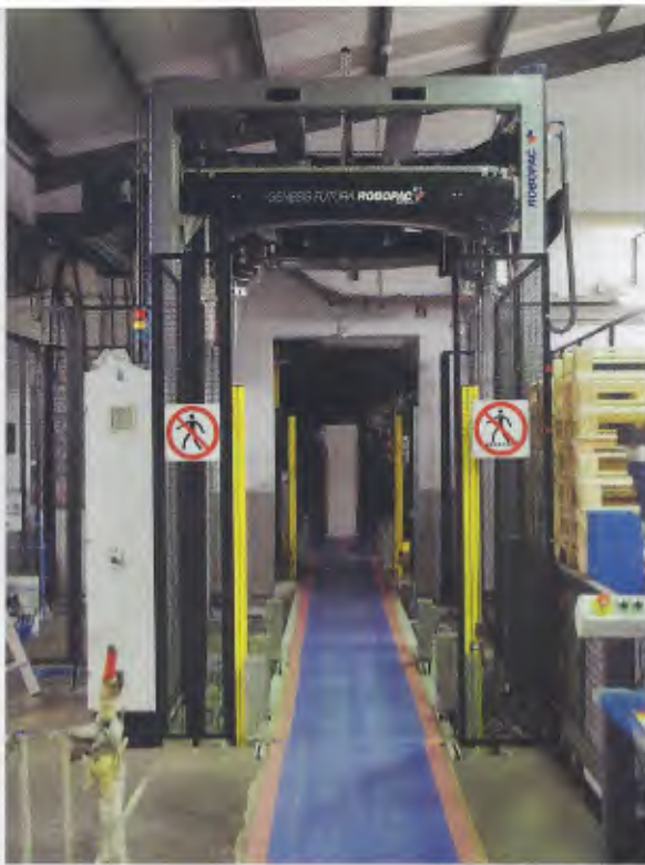
Der Robopac-Stretchfolienroboter gehört zur 2014 installierten Versandlinie.
